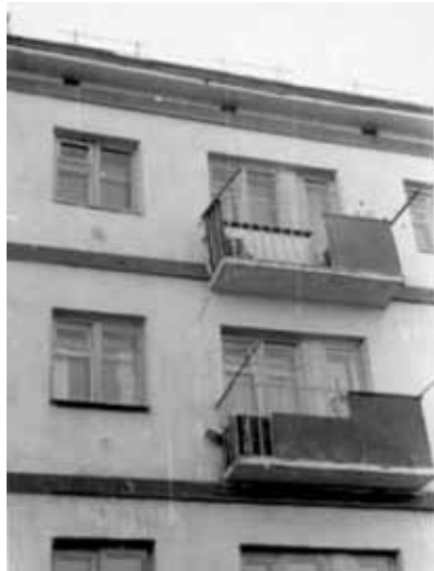
Рис 2. Фото здания, приспособленного к неравномерным деформациям способом устройства металлических поясов жёсткости в уровне каждого перекрытия. Причина подобных усиления - развитие неравномерных осадок, вследствие оттаивания линзы многолетней мерзлоты.
